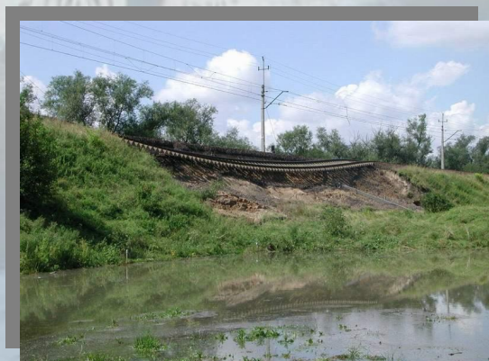
Rys. 4 Osuwisko na Linii Kolejowej
